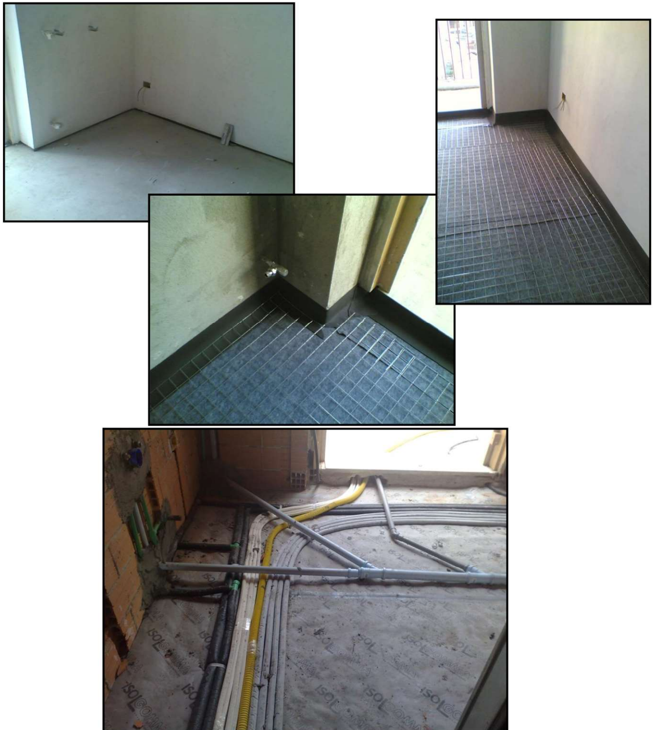
Figura 9 - posa del materiale in cantiere – sopra alleggerito e sotto alleggerito – in caso di posa di pannello radiante il materiale anticallpestio va posato sotto il pannello radiante
