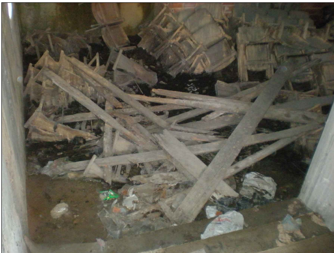
FOTO 13 - LA SITUAZIONE DEI LOCALI AL FONDO DELLO SCALONE DI INGRESSO ALL'INTERRATO
