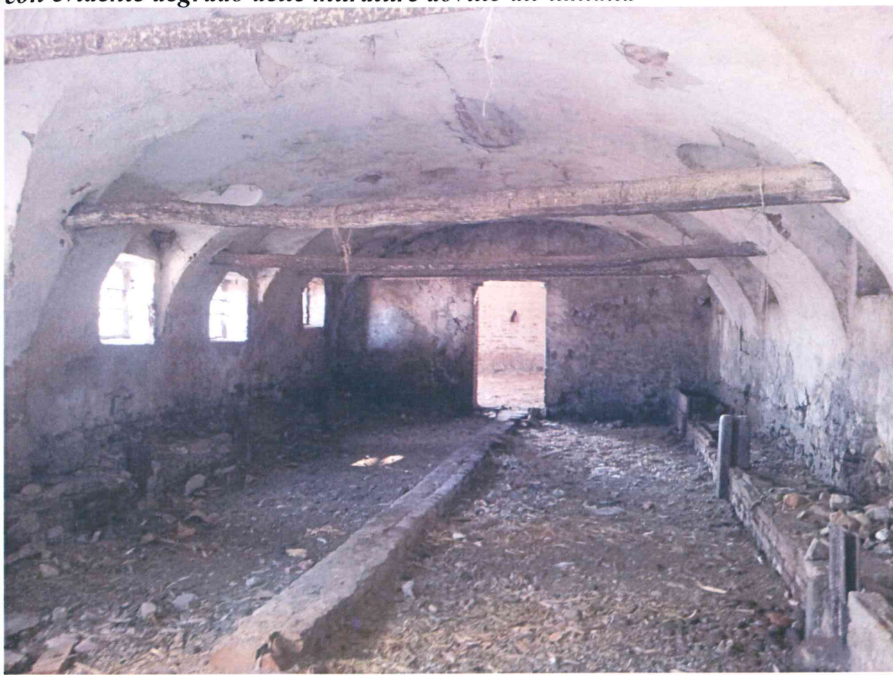
Foto interna della stalla fatiscante e con altezze inidonee a qualsiasi utilizzo con evidente degrado delle murature dovuto all'umidità
