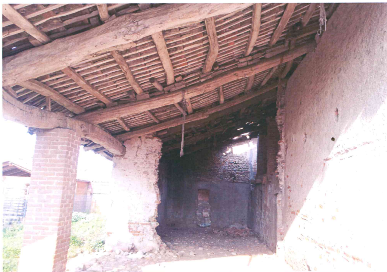
Fotografia porticato retrostante: precarietà delle strutture e delle murature
