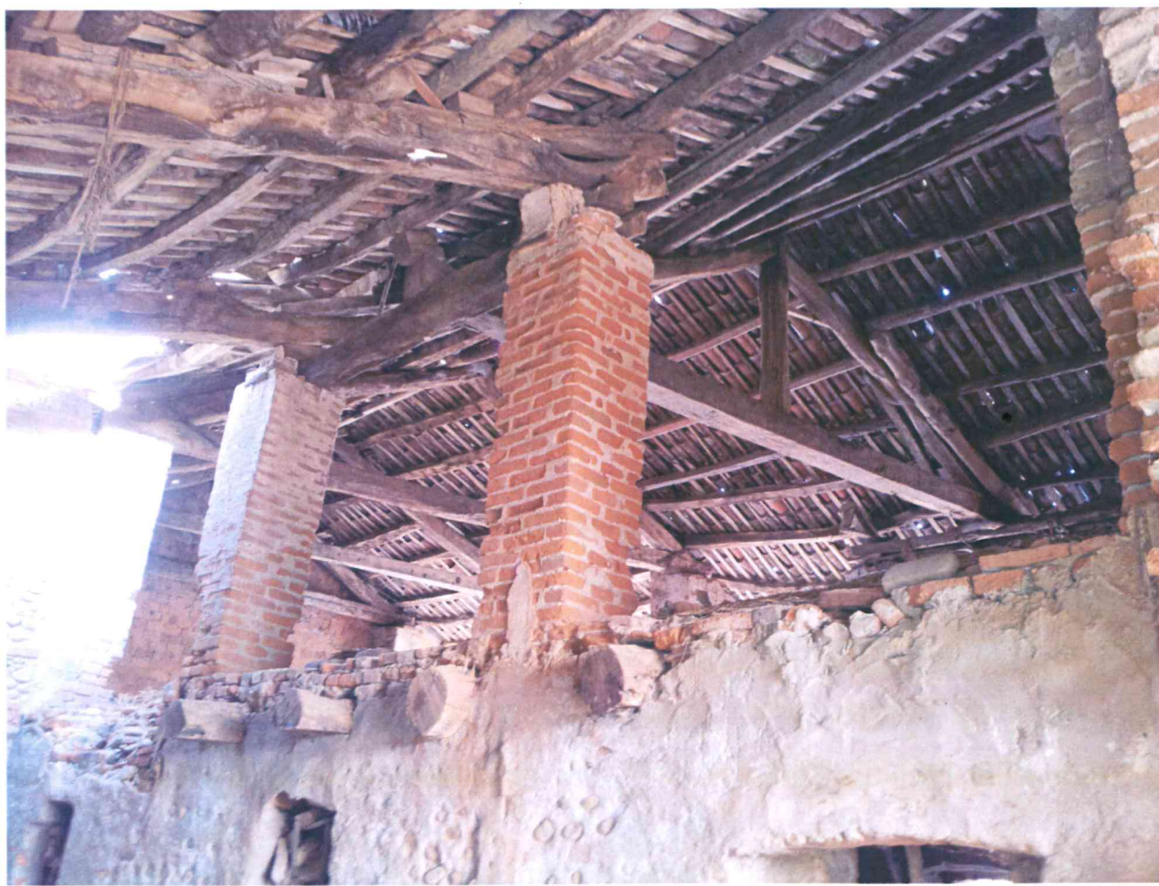
Fotografia dimostrante l'obsolescenza del tetto sull'ex fienile
