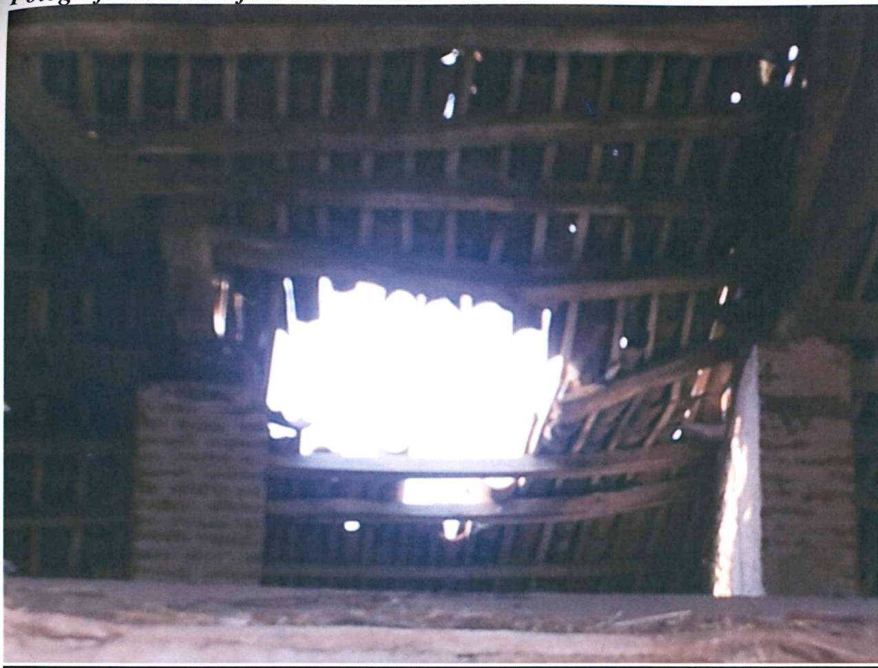
Fotografia strutture fatiscenti del tetto
